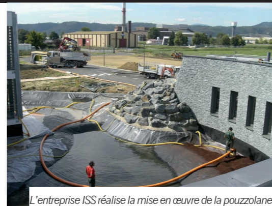
L'entreprise ISS réalise la mise en œuvre de la pouzzolane 5/15 destinée aux zones de plantation d'un bassin décoratif.
